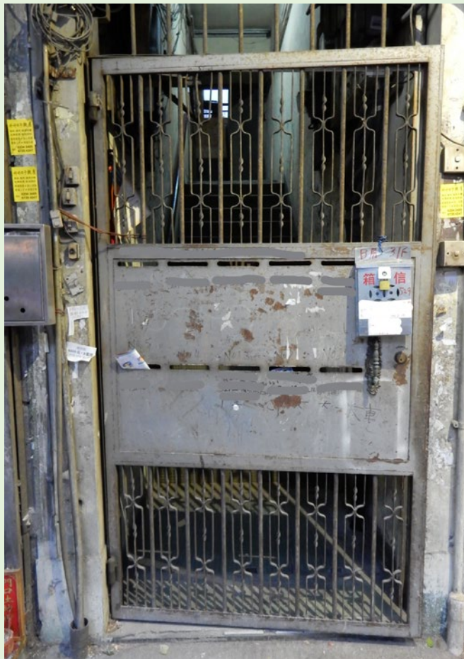
不少舊唐樓之大廈鐵閘只能虛掩，閒雜人等可以隨便出入大廈。
